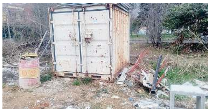
Cantiere abbandonato. Il Comune ha dato 15 giorni di tempo per sistemarlo
